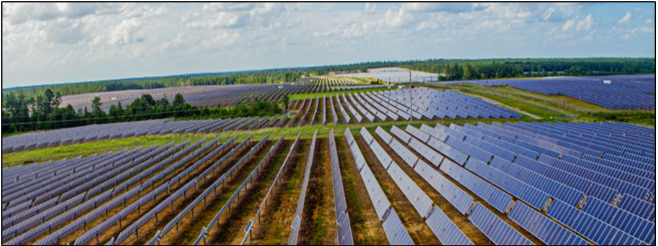
Figur 3: Solcellepark med solceller monteret på trackerstystem
