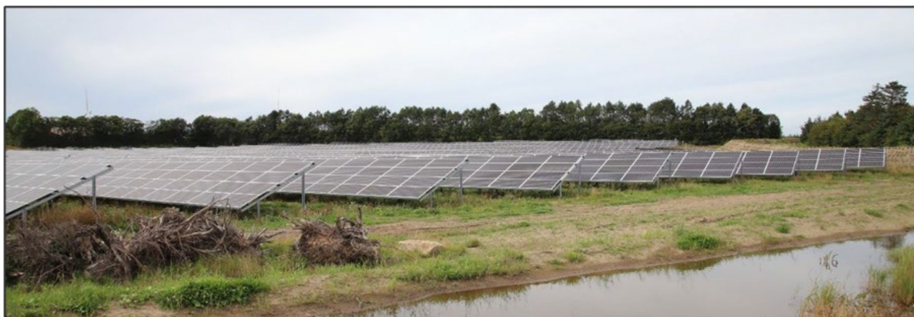
Figur 2: Solcellepark med solceller monteret på faste stativer.
