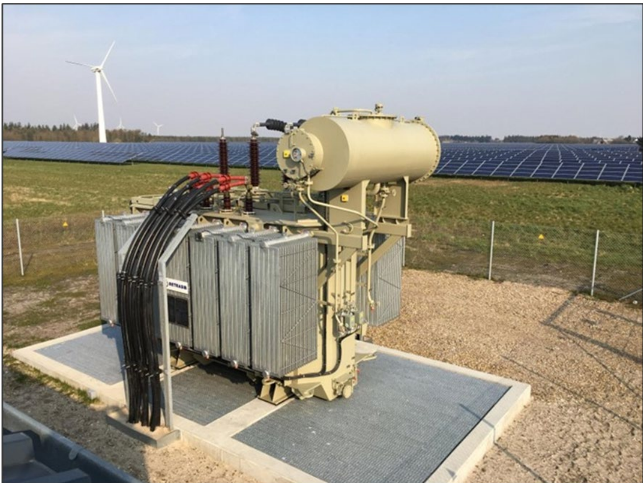
Figur 5: Eksempel på fritstående transformerstation
